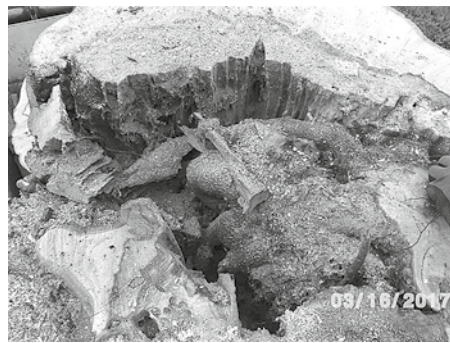
Stammquerschnitt an der vorhandenen Schadstelle
